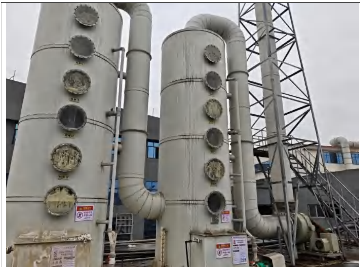
浆染、烘干废气设施、排气筒 DA003（提升改造措施）
