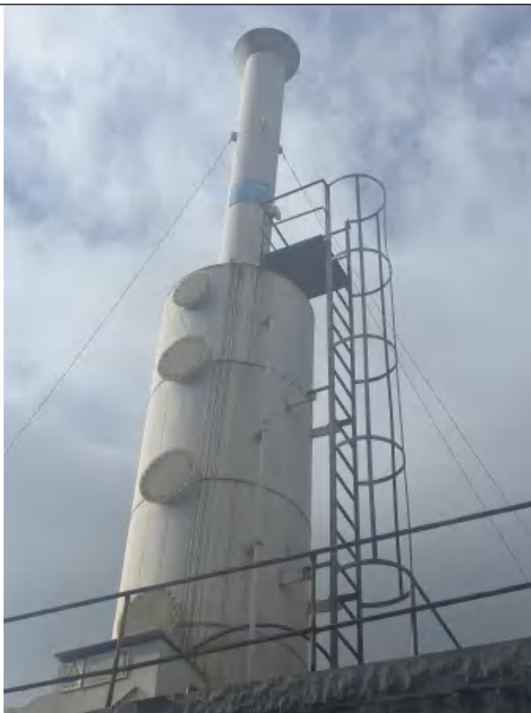
污泥房废气处理设施、排气筒（提升改造措施）
