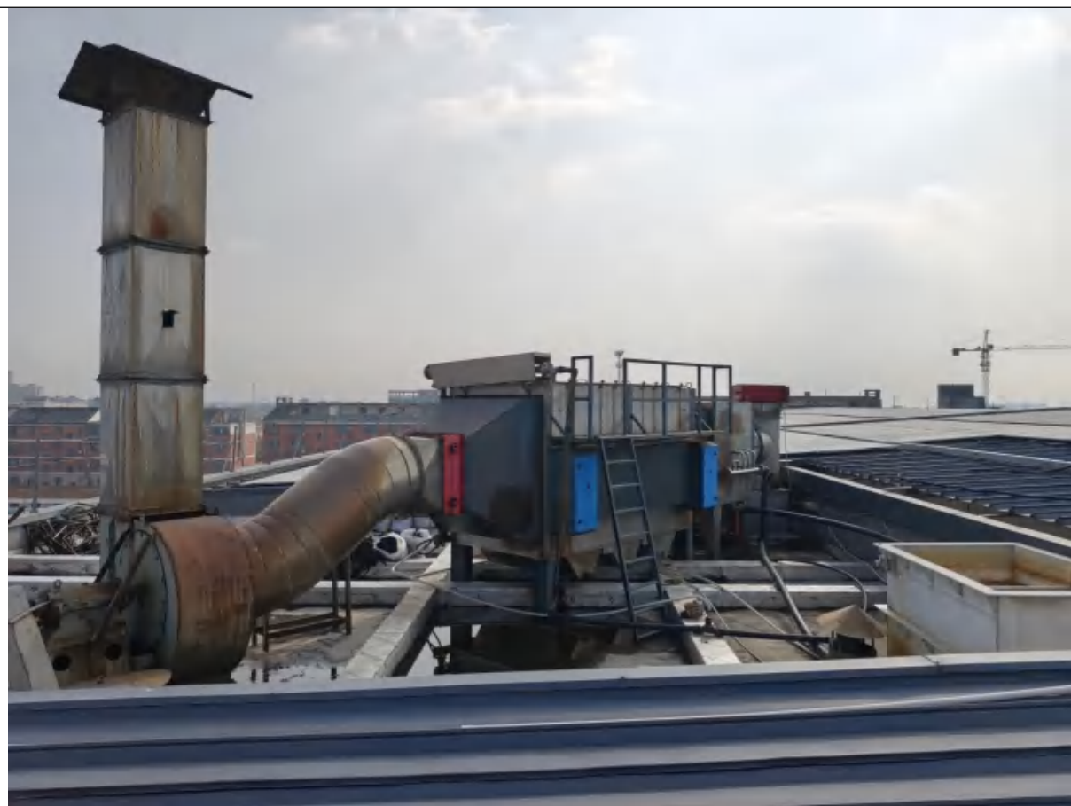
烧毛废气设施、排气筒 DA002
