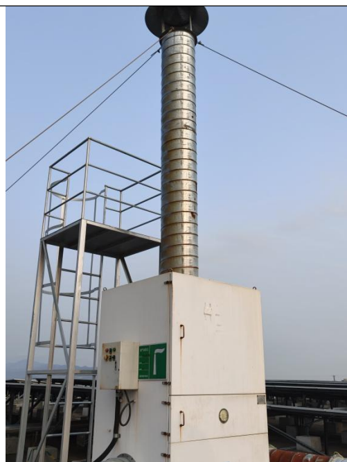
含砷废气处理装置
