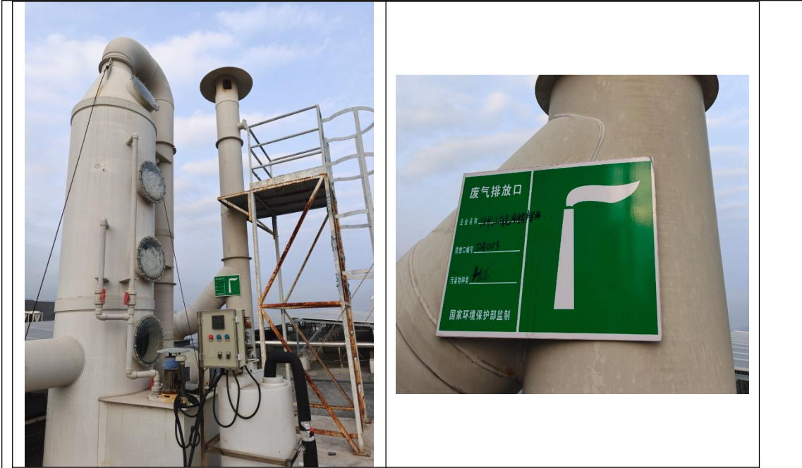
分析室废气处理装置
