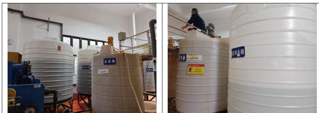
含砷废水处理设施
