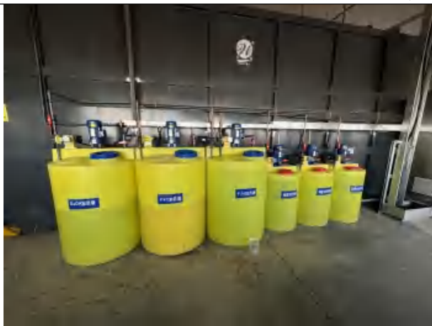
室内污水处理单元
