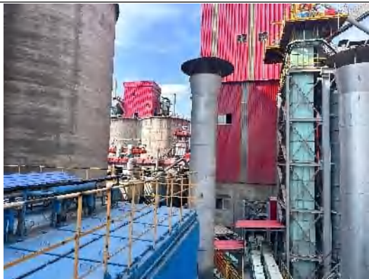
二线水泥磨处理设施及排气筒
