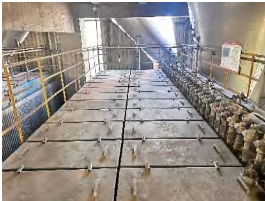
二线提升机、选粉机、辊压机处理设施
