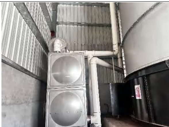
有机肥半成品车间生物除臭设施
