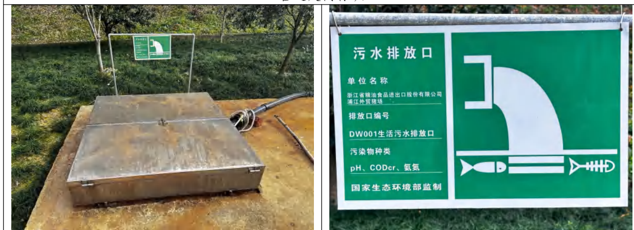
暂存池出水口 (泵送农田灌溉)
