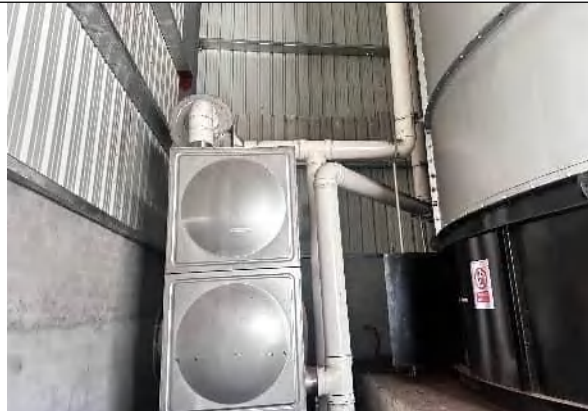
生物除臭设施
