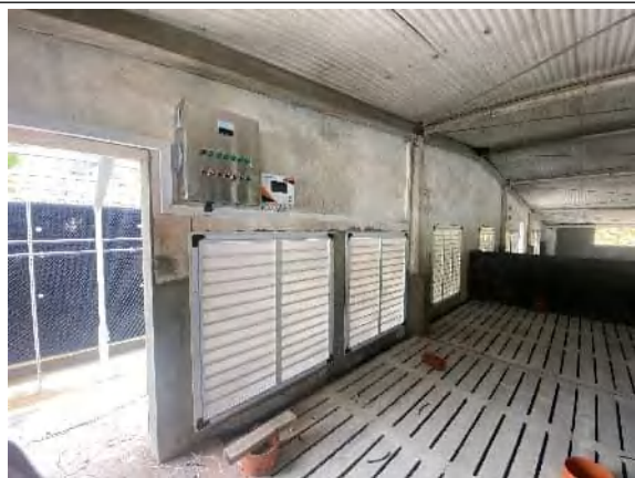
猪舍除臭间引风系统
