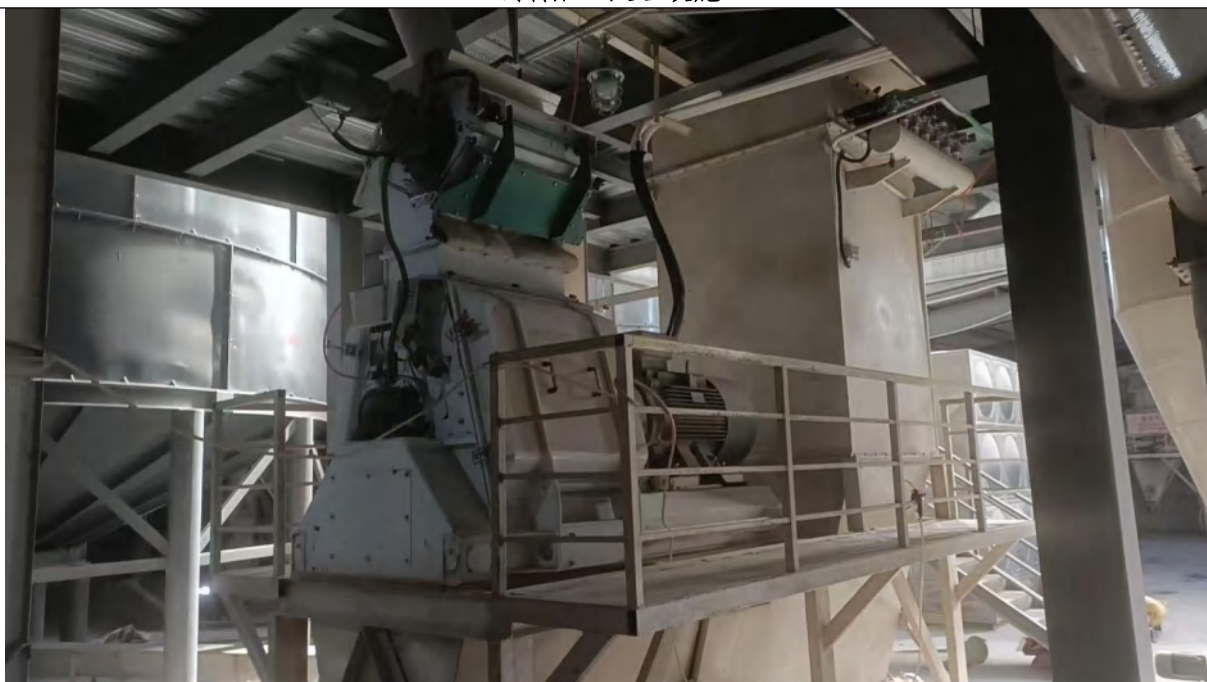
布袋除尘设施 沼气发电处理设施
