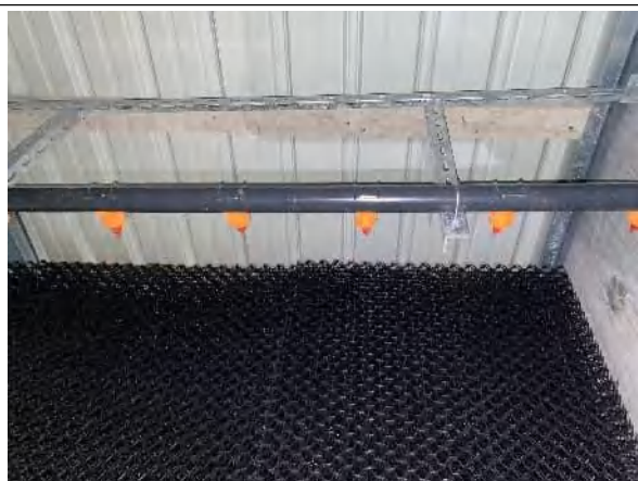
废水处理系统除臭间
