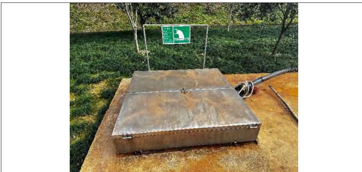
暂存池出水口（泵送农田灌溉）
