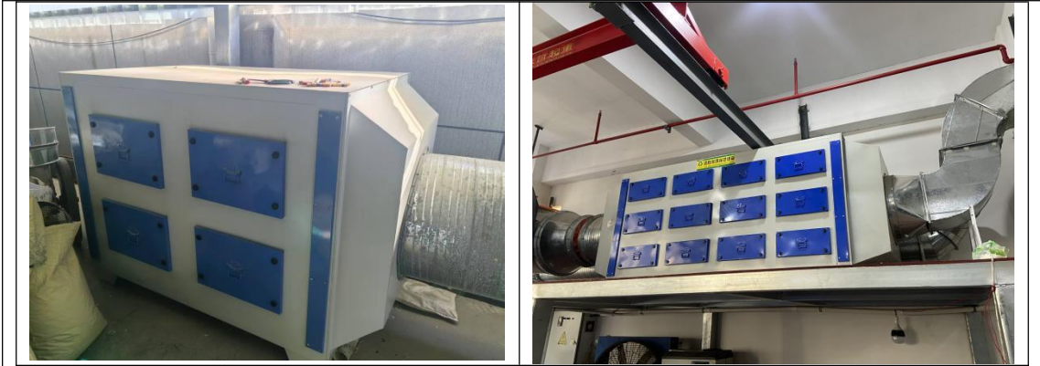
DA002废气处理设施
