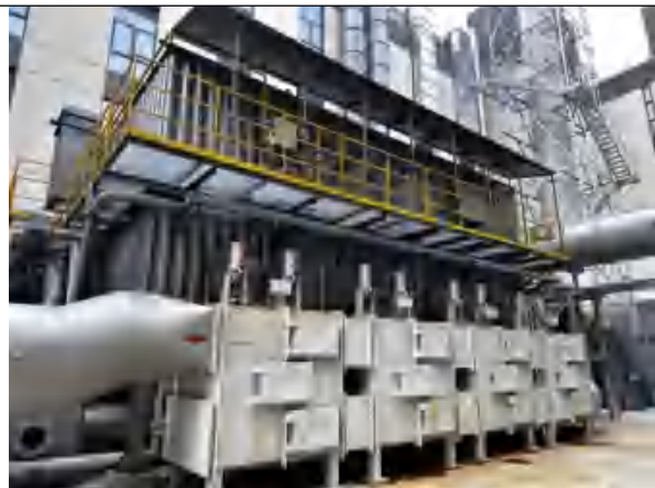
TA009 B 线“气旋+水喷淋+RTO”设施
