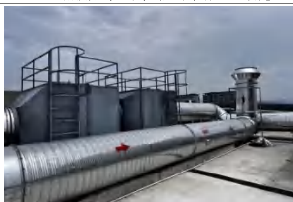
TA007 组装废气“活性炭吸附”设施
