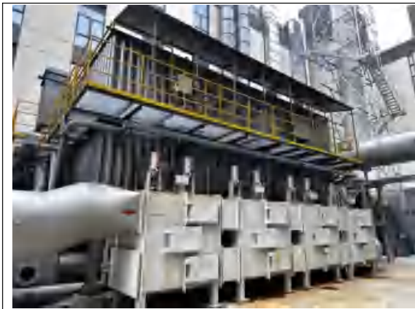
TA009 B 线“气旋+水喷淋+RTO”设施
