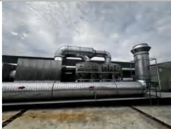
TA004 镗雕废气“水喷淋+布袋除尘”设施 1
