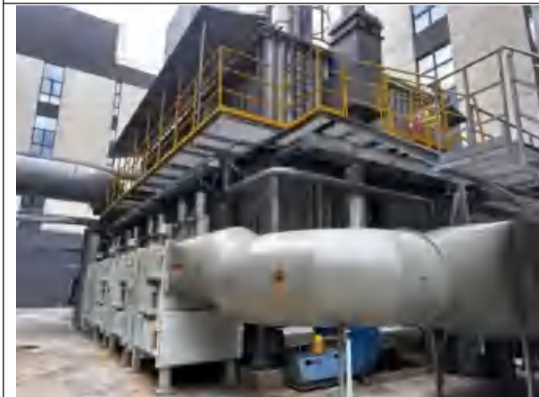
TA010 D 线“气旋+水喷淋+RTO”设施
