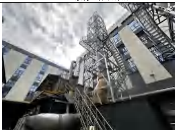
DA008C 线 RTO 排气筒及走梯
