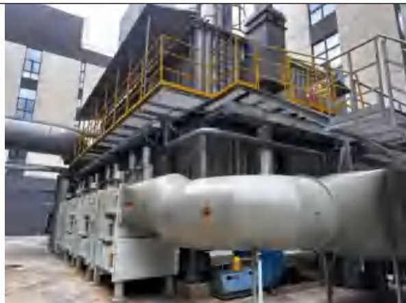
TA010 D 线“气旋+水喷淋+RTO”设施
