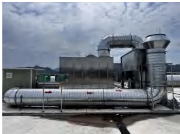
TA003 模具打磨废气“水喷淋+布袋除尘”设施
