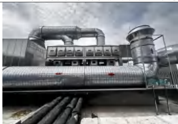
TA005 镗雕废气“水喷淋+布袋除尘”设施 2
