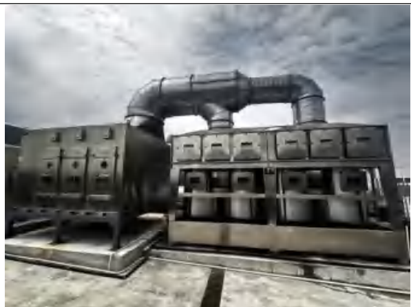
TA014 镗雕废气“水喷淋+布袋除尘”设施3
