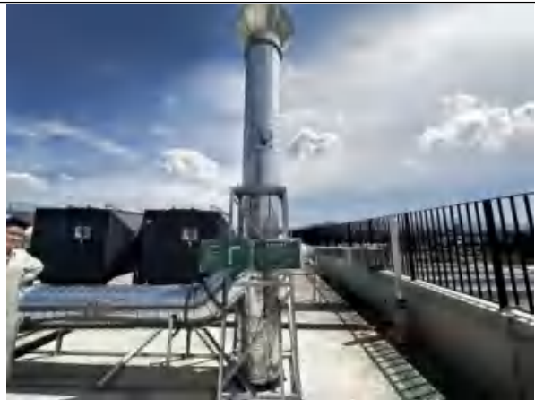
TA013 危废暂存库“活性炭吸附”设施
