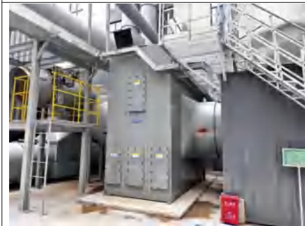
TA012 “一级喷淋+三级干式过滤+沸石转轮吸附脱附”设施
