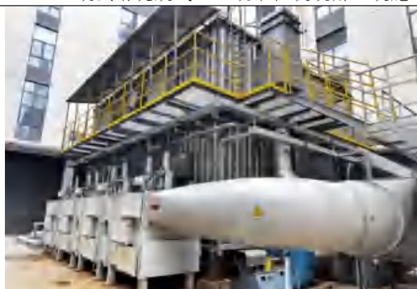
TA008 C 线“气旋+水喷淋+RTO”设施
