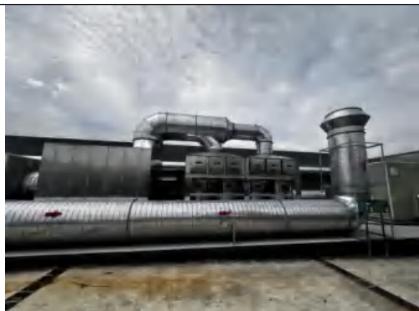
TA004 镗雕废气“水喷淋+布袋除尘”设施 1
