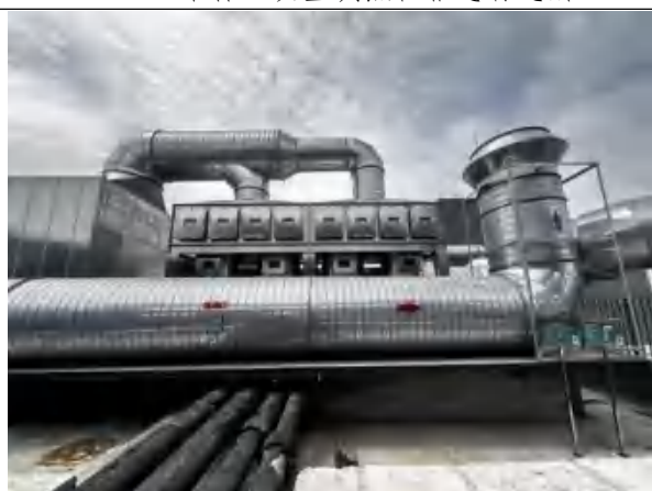
TA005 镗雕废气“水喷淋+布袋除尘”设施 2
