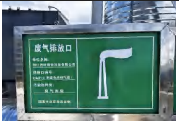
DA013 排放口标识标牌
