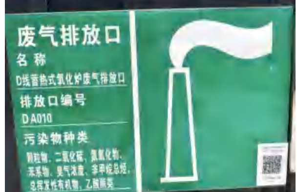
DA010 排放口标识标牌
