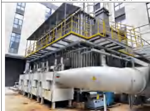
TA008 C 线“气旋+水喷淋+RTO”设施
