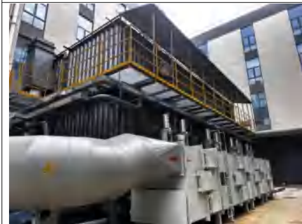
TA011 A 线“气旋+水喷淋+RTO”设施
