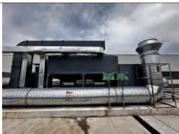
TA002 注塑、丝印废气“活性炭吸附脱附+催化燃烧”设施 2
