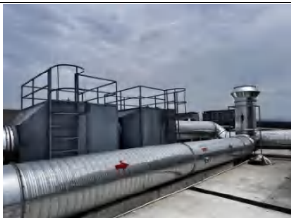
TA007 组装废气“活性炭吸附”设施
