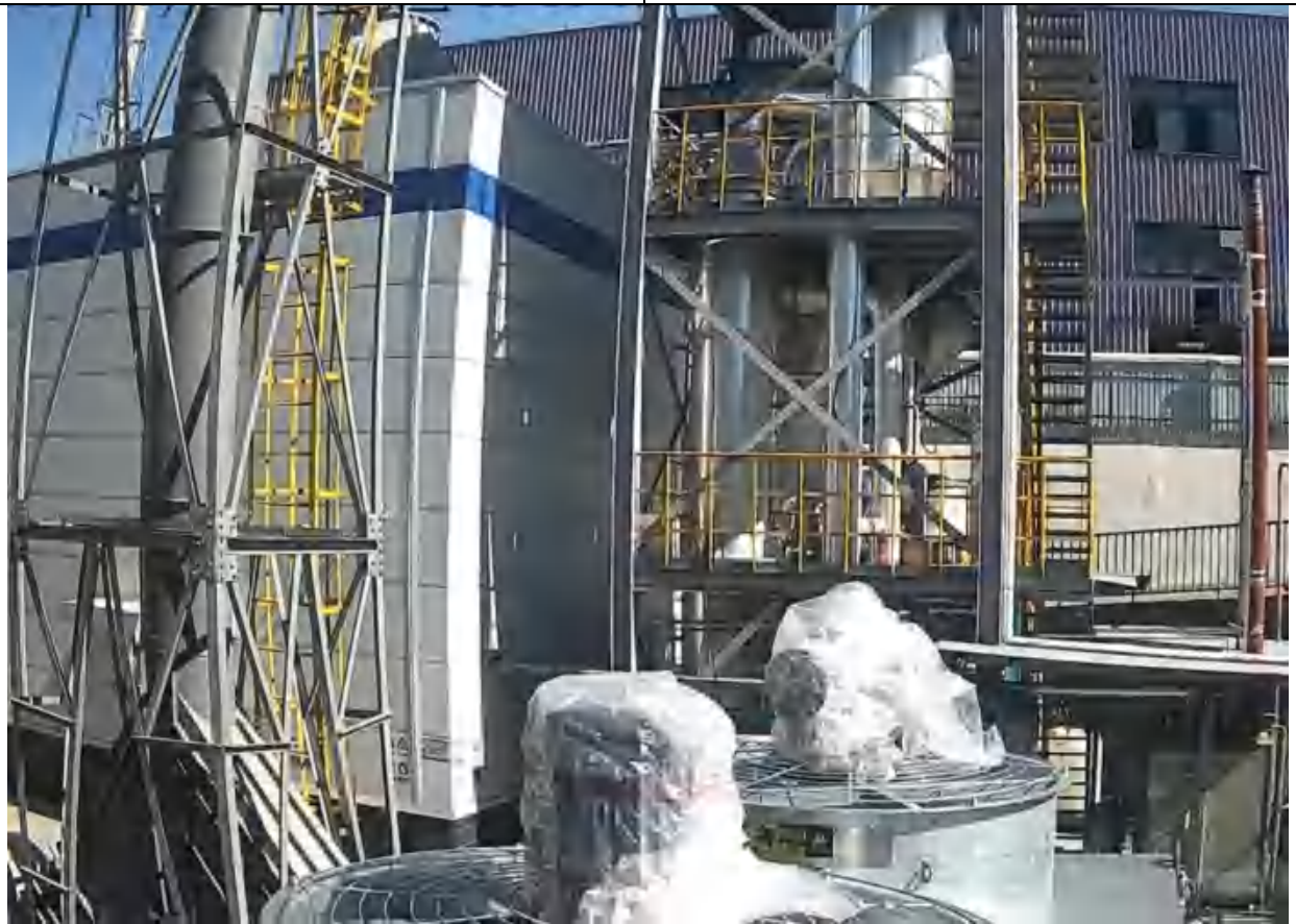
MVR 废水蒸发
