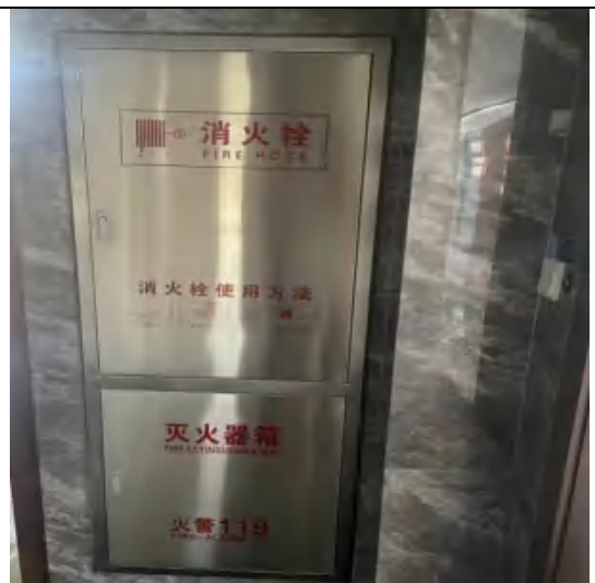
室内、外消防栓
