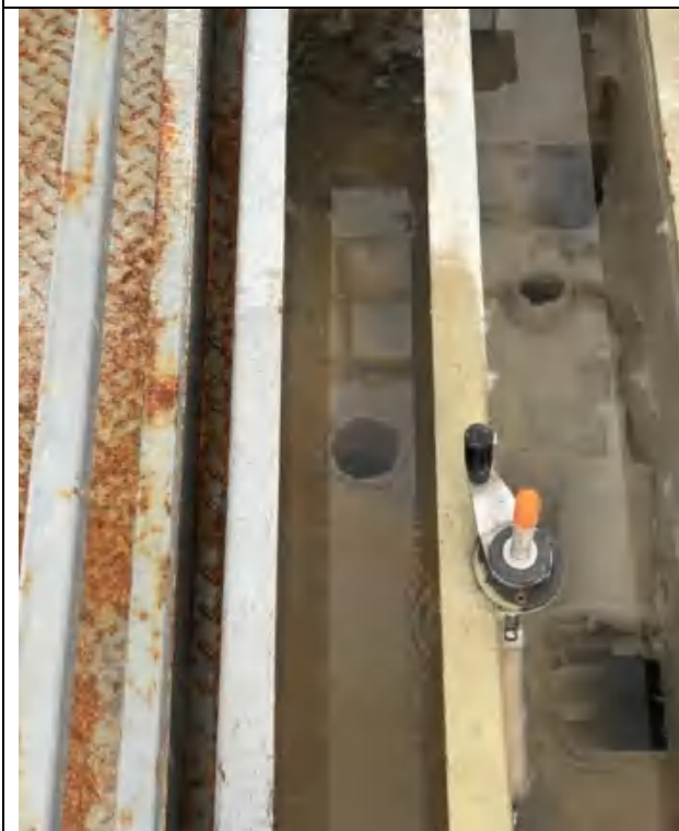
一体化气浮池
