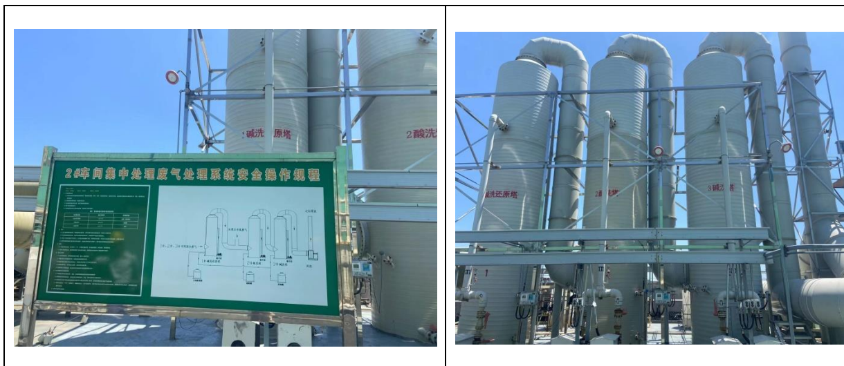
无机废气集中处理系统
