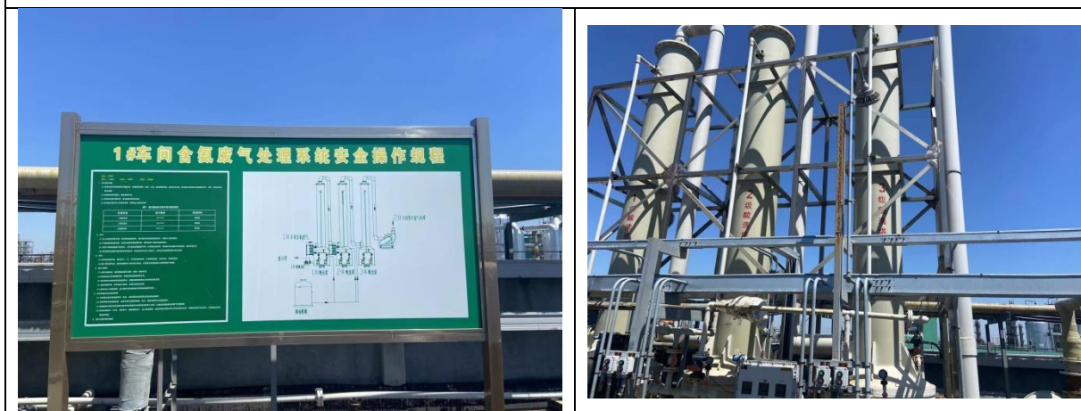
含氨废气预处理设施
